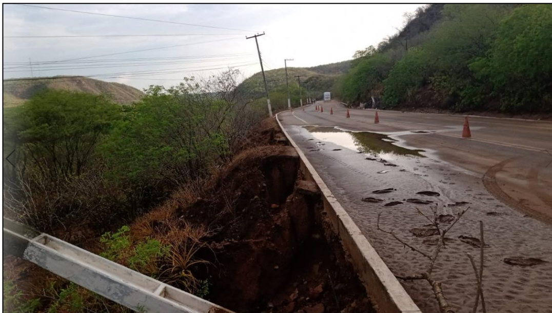
Forte erosão (Fonte: Equipe Energisa)
