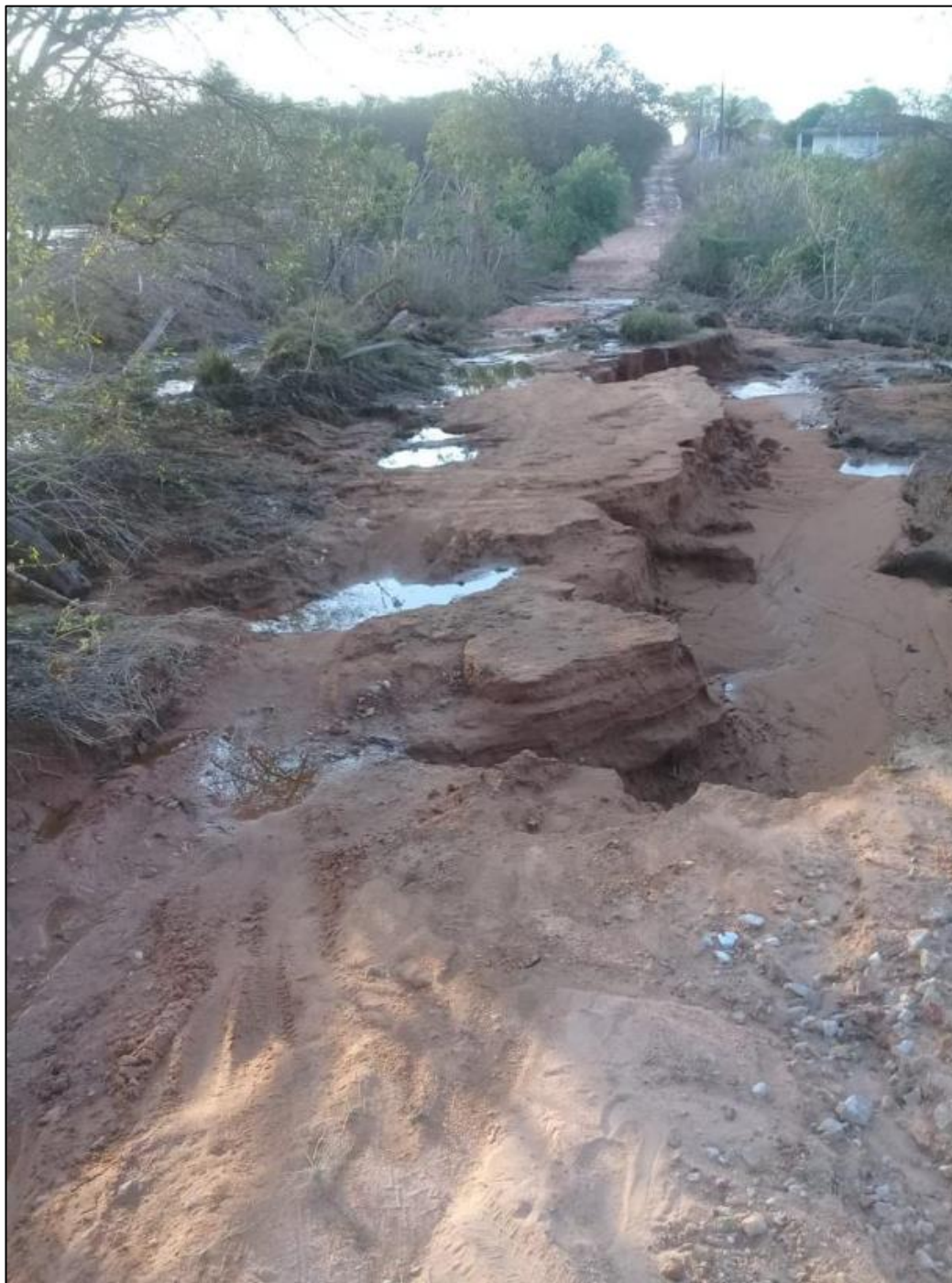
Forte erosão em estrada dificultando acesso a localidades (Fonte: Equipe Energisa)
