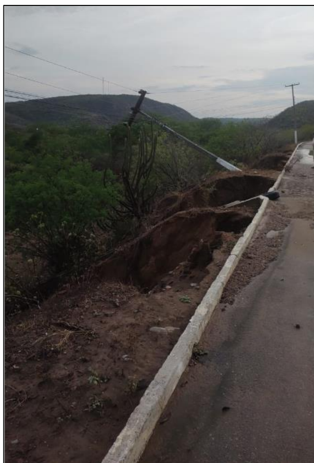
Forte erosão (Fonte: Equipe Energisa)
