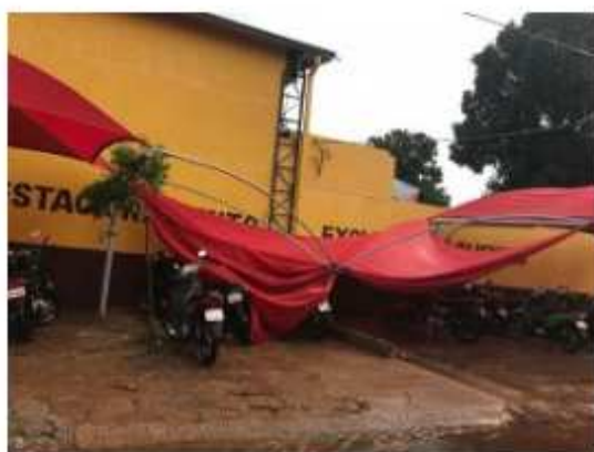
Cobertura de estacionamento caiu em cima de veículos. (Foto: BV News)
