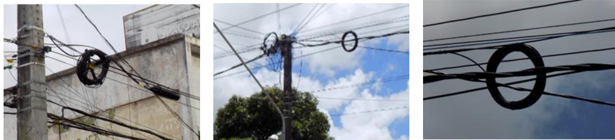
Figura 06. Instalações irregulares de reversas técnicas tipo cruzeta.
