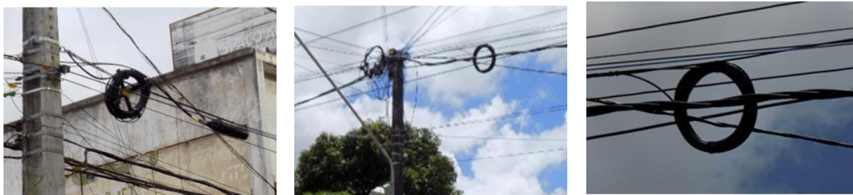
Figura 06. Instalações irregulares de reversas técnicas tipo cruzeta.
