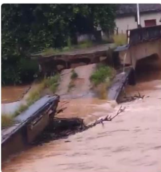
Ponte foi levada pela enchente em Cataguases — Foto: Nelson Szwarc/Reprodução
