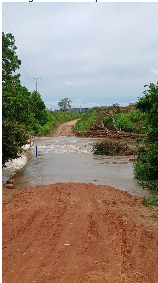
Figura: Ruas de difícil acesso
