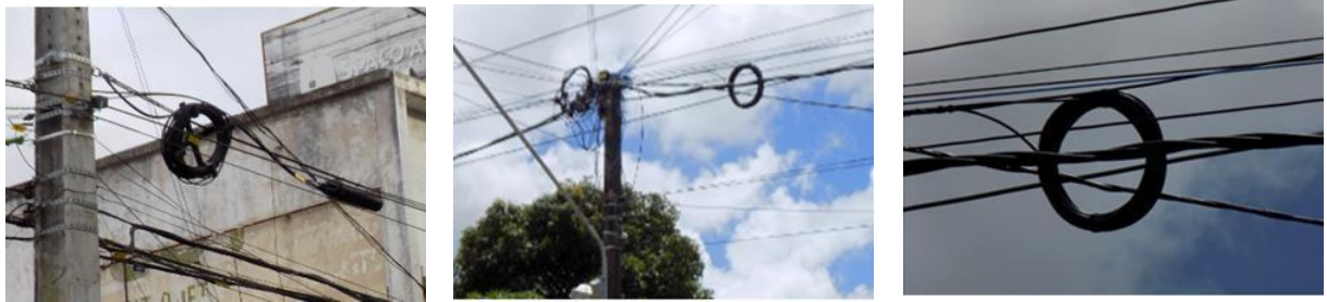
Figura 06. Instalações irregulares de reversas técnicas tipo cruzeta.
