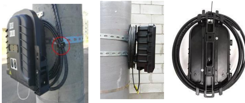
Figura 10. Caixas CTO/NAP com cabo de descida acomodação na traseira da caixa.
